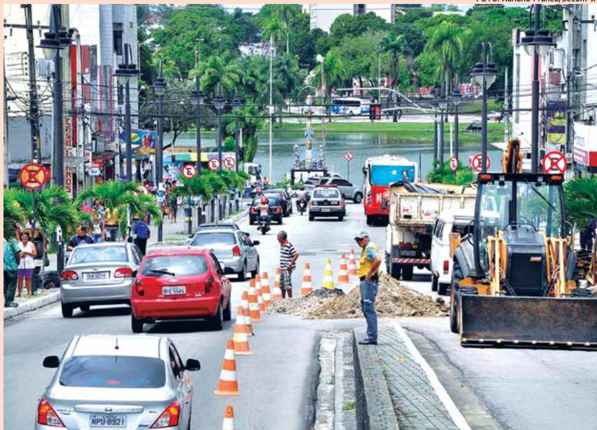
No início da Avenida Padre Meira uma rede de esgotos estourou e foi necessário interditar o trecho
